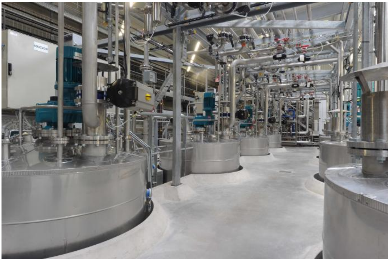
Pilote Futurol TM - Atelier hydrolyse et fermentation.
