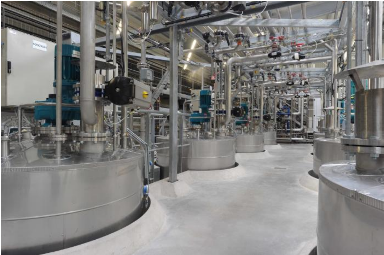
Pilote Futurol TM - Atelier hydrolyse et fermentation.
